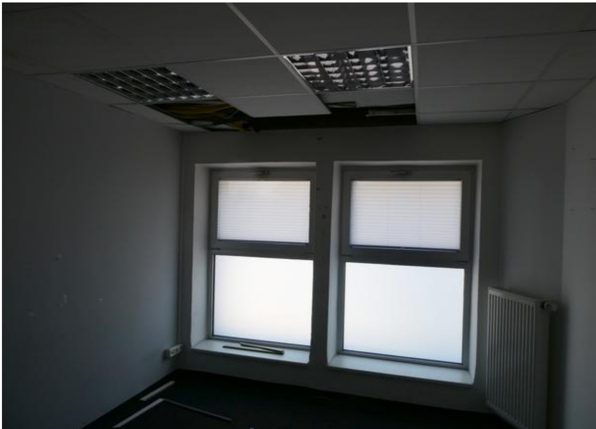
Abbildung 43: Beispiel Büroraum (Gebäudeteil 5) mit losen Deckenplatten.
