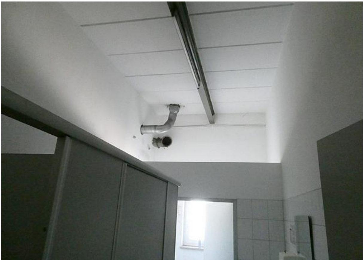
Abbildung 38: Decke Sanitärbereich (Gebäudeteil 4)
