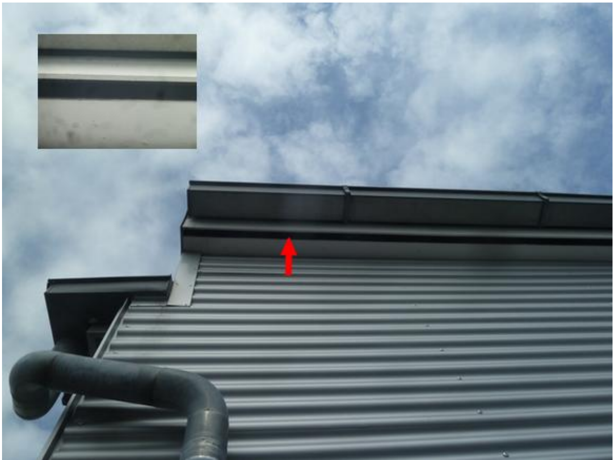
Abbildung 59: Spalte am Dachtrauf, an der westlichen Gebäudefront linke Seite
