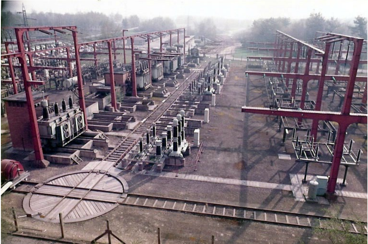
Drehstrom-Freiluft-Schaltanlage (35 kV, 110 kV) in Dachelhofen (Bild Georg Wickles)
